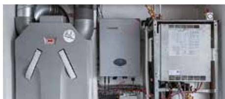
4. Techniekkast met LWW-pomp en ventilatiesysteem. De techniekkast wordt op de zolder van de woning geplaatst.
