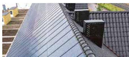
8. PV-panelen als dakbedekking en schoorsteen met buitenunit van de LWW-pomp.
